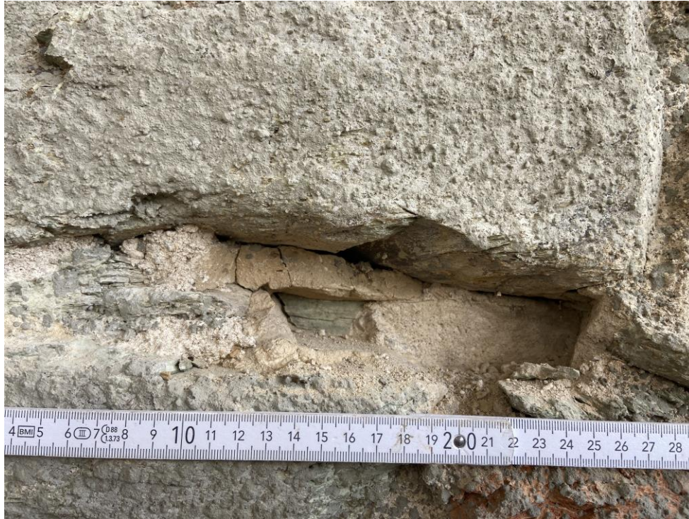
Abb.: 144: Detail Übergang Königsflügel / Wagenhalle. Im Befund deutlich sichtbar die unterschiedlichen Mörtel der beiden Bauteile. Der südliche Bereich (links) gröberer älter Mörtel, leicht entfestigt. Der jüngere, nördliche Bereich mit einem feineren, gelblicheren Mörtel (rechts). Foto: Nils Wetter
