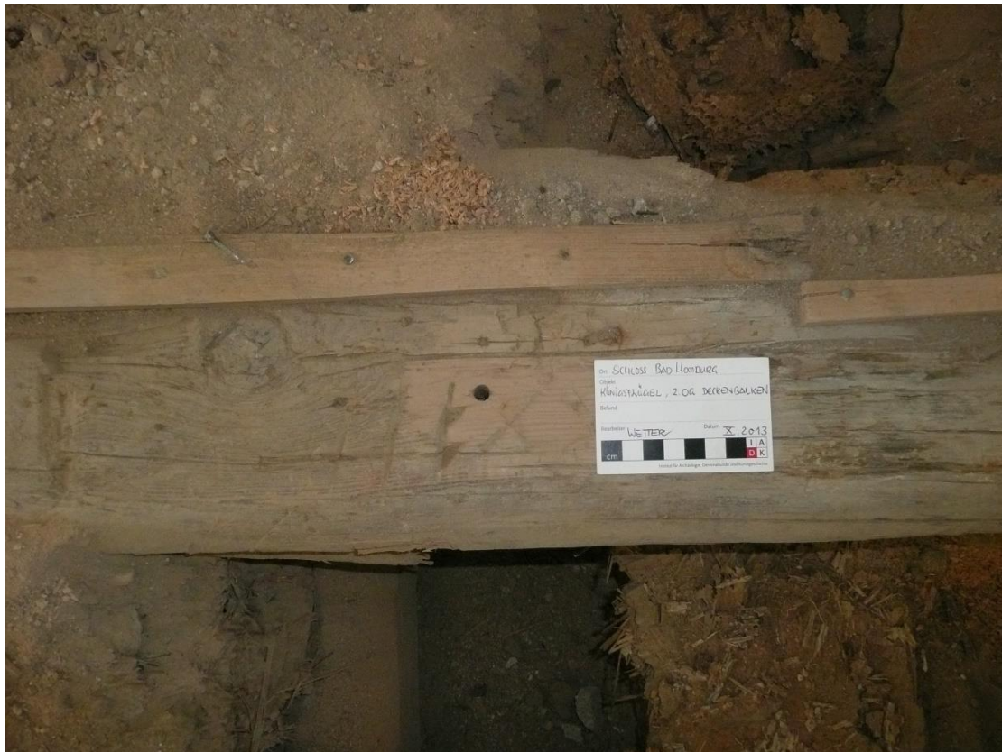
Abb. 209: Abbundzeichen im Deckenbalken des 2. Obergeschoss des Königsflügels. Bild: Nils Wetter
