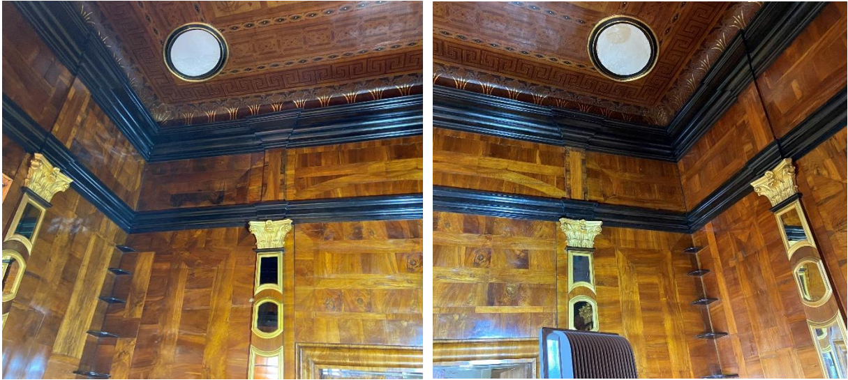
Abb. 226: Innenansicht des Kabinetts nach Süden. Auf dem linken Bild erkennt man die gekürzte Vertäfelung. Um den Raum einheitlich zu gestalten wurde die Decke verändert. Bilder: Nils Wetter
