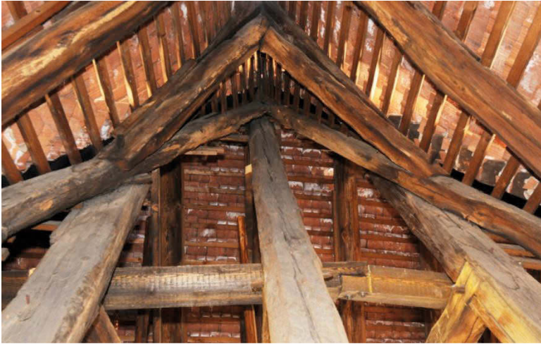
Abb. 18: Anschluss des Dachwerks über dem Nordflügel an das Dachwerk über dem Ostflügel. V-förmiges Begrenzungsholz, auf das mit Schifterschnitten die Gratsparren aufgesetzt sind.
