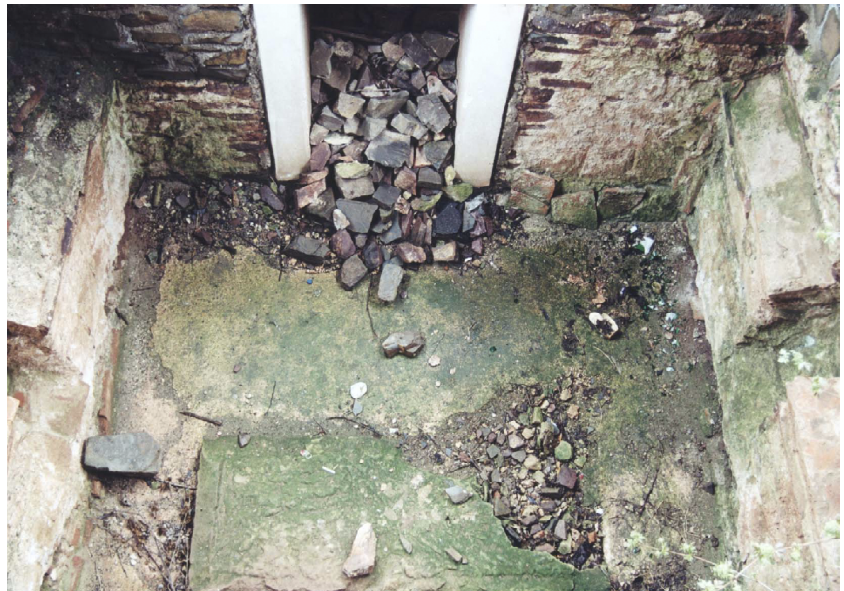
Abb. 403 Zustand der Grabkammer II im März 2002 nach einer freien Bewitterung von 28 Jahren, vor Beginn der Konservierungsarbeiten. Der mittlerweile stark geschädigte Estrich ist mit Fehlstellen durchsetzt, in sich gelockert und stark durch Algenauflagen belegt.
