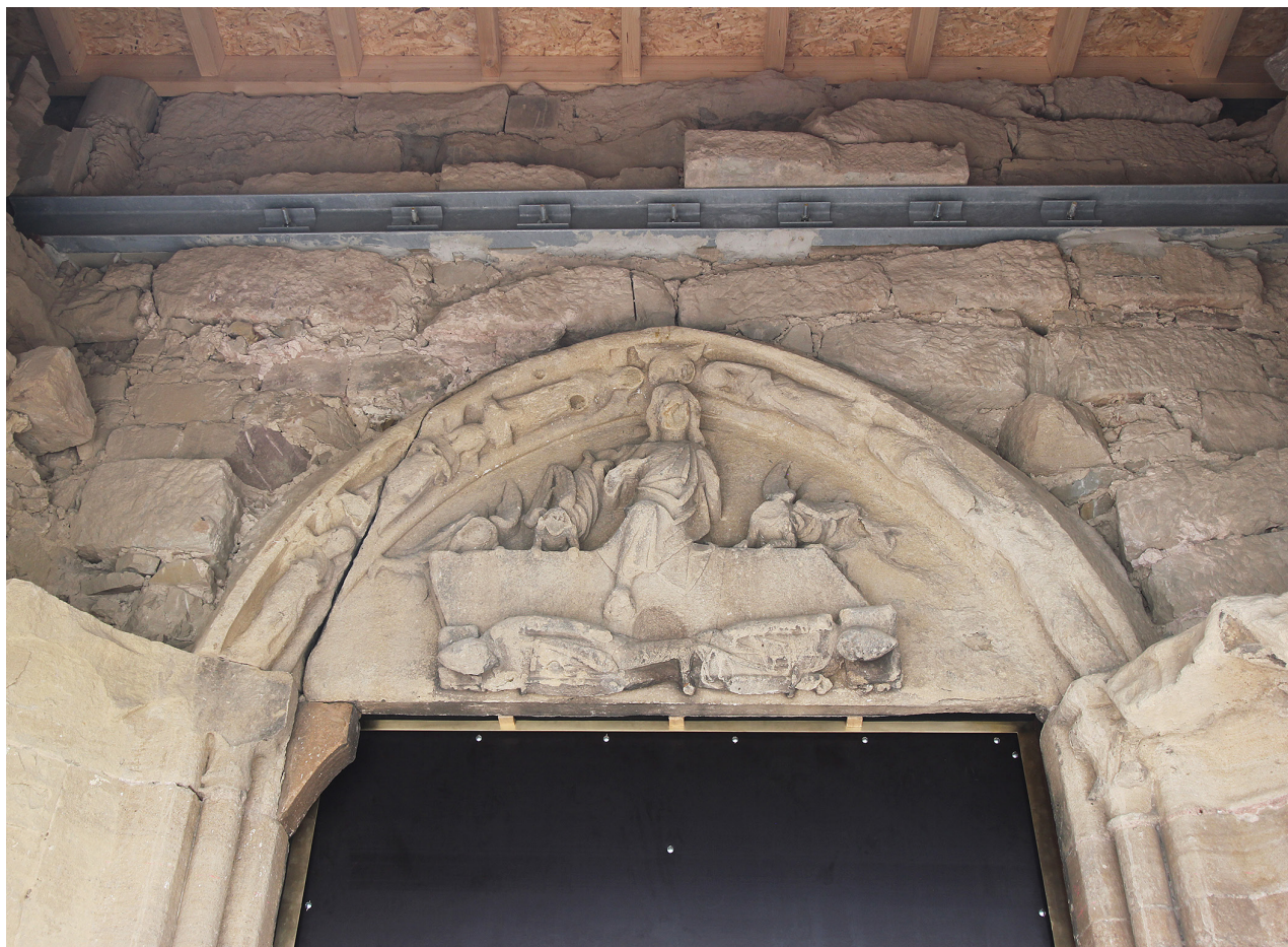
Abb. 4 Tholey, Benediktinerabtei, Nordportal, in situ verbliebener Tympanonstein mit statischer Sicherung
