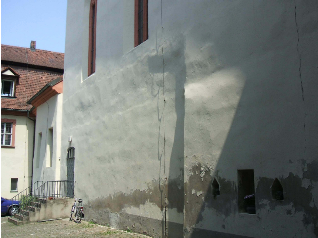
Abb.17.124: Blick auf die nördliche Westfassade des Langhauses. Sichtbar sind Farbschichtablösungen, die mit einem weißen Salzhorizont einhergehen.
