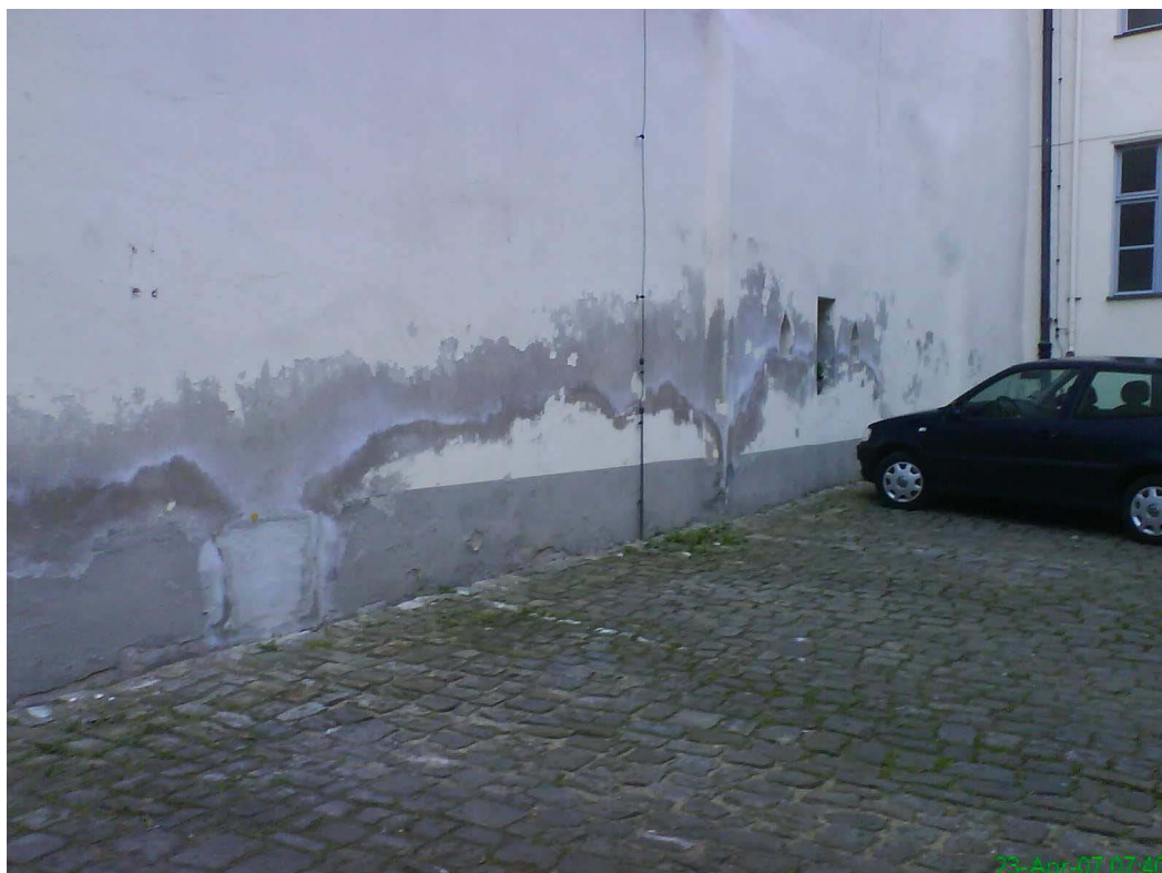
Abb.17.125: Blick auf die südliche Westfassade des Langhauses. Sichtbar ist ein weißer Salzhorizont.
