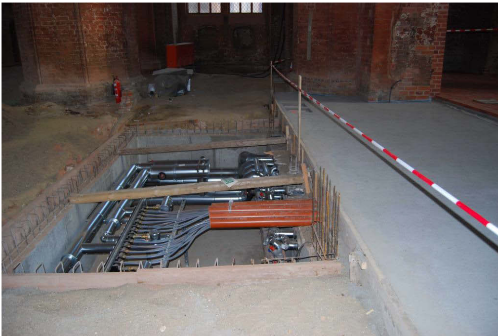
Abb. 7. Wismar, St. Georgen, Fpl. 68. Kampagne 2007/08, Verteilerstation in A50/51. Blick von Süden nach Norden, 24.08.2007.
