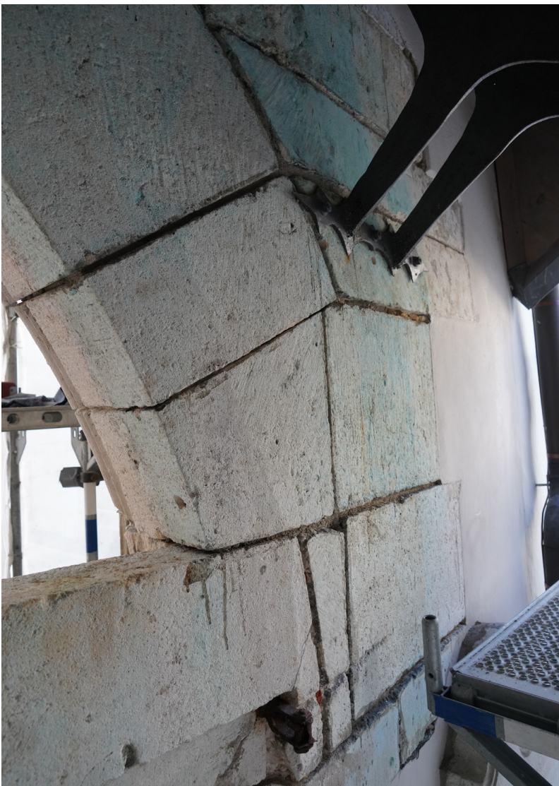
Abb. 10 Passau, St. Stephan, Portal zum ehemaligen Kreuzgang, Abarbeitungen an der Rückseite (Innenseite) der östlichen Portalhälfte
