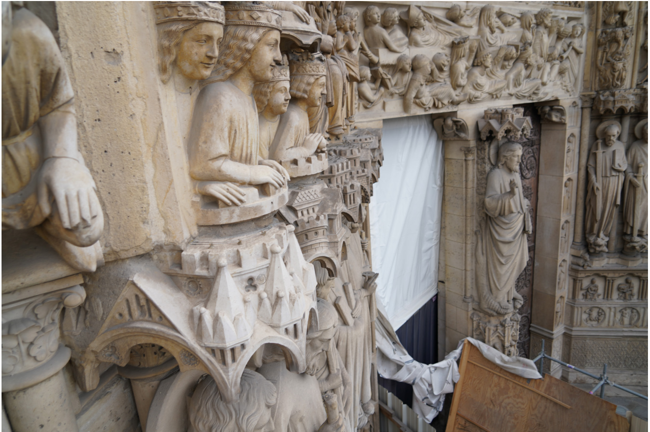
Abb. 9 Paris, Notre-Dame, Weltgerichtsportal, linkes Gewände, Verschiebung zwischen Figurenarchivolten und Baldachinfries
