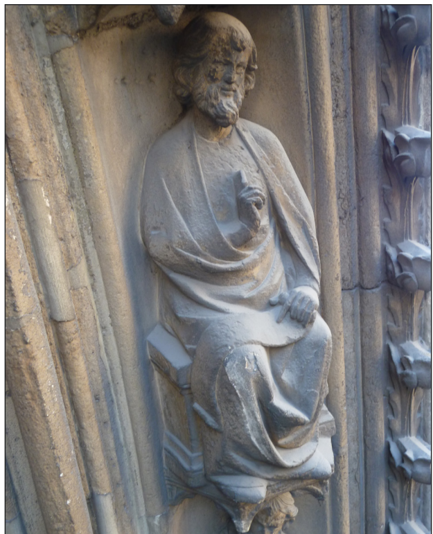
15 PARIS, NOTRE-DAME, NÖRDLICHES QUERHAUSPORTAL, SPUREN DER REPARATURMASSNAHMEN VON ETIENNE-HIPPOLYTE GODDE AB 1843, ANSICHT 2016
