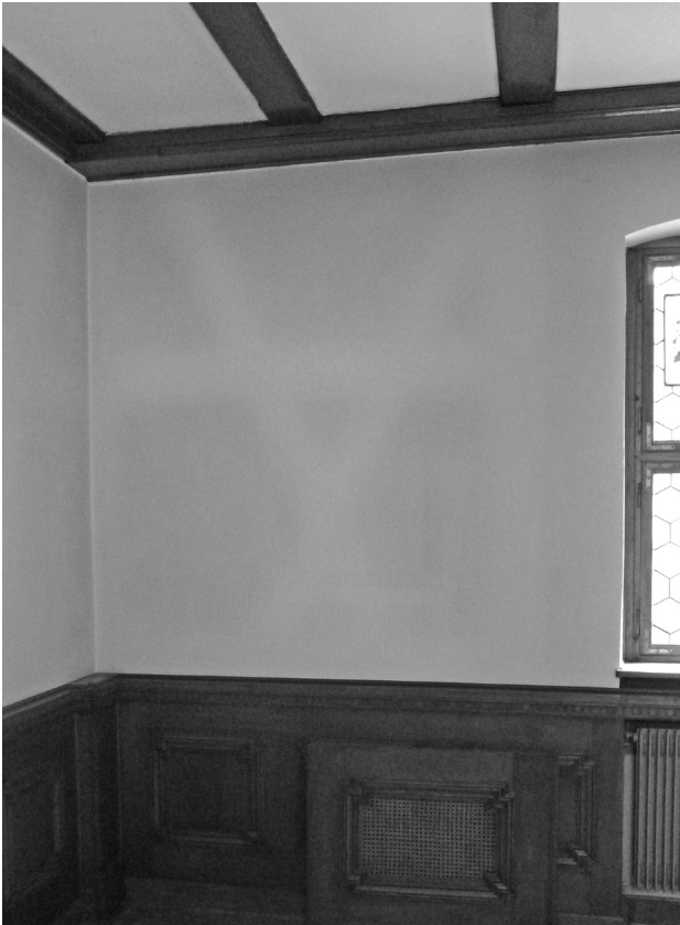
1 Obbach, Altes Schloss, Raum 204, Wand a. Die Fachwerk-Tragkonstruktion der Wand wird durch unterschiedliche Feuchtigkeitsverteilung sichtbar.
