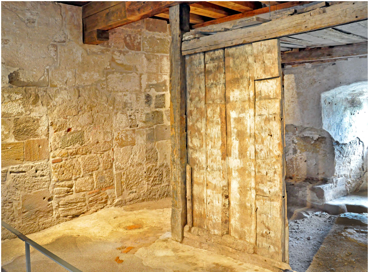
11 Veste Heldburg, Heidenbau, Erdgeschoss. Ehemalige, heute im Rahmen der Ausstellung zugängliche Bohlenstube mit Holzbauteilen von 1508/09 (d) (Restaurierung: Burkhard Schmidt; Leitung: Jürgen Scholz).
