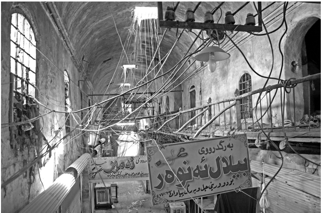
1 Erbil, restaurierungsbedürftiges Tonnengewölbe des spätmanschen Basarbaus Qaisariya Ost.
