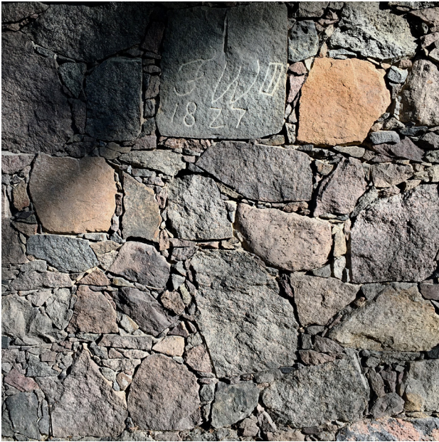
9 Kloster Chorin, Wirtschaftsgebäude, Südfassade an der Landstraße, Feldstein mit steinmetzmäßig hergestellter bauzeitlicher Inschrift „FW III/1827“, Aufnahme 2017.
