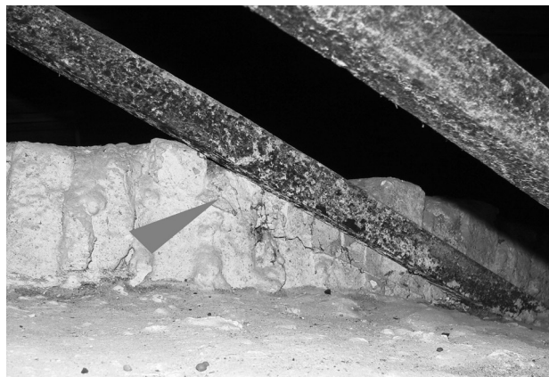
12 Wie Abb. 7. Abdrücke der Eisenanker an den Gewölberippen der ursprünglich steiler verlaufenden Gewölbeform.
