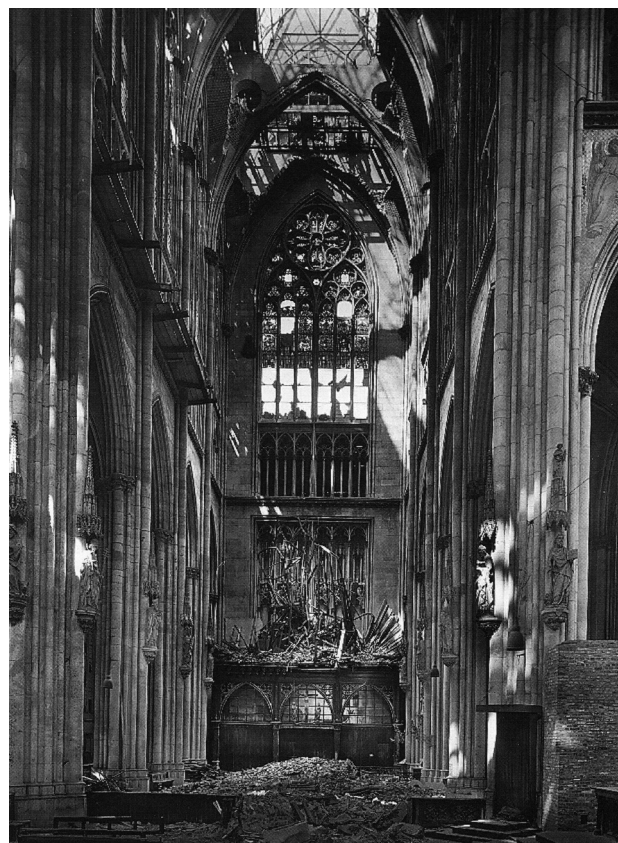
26 Köln, Dom. Innenraum, Blick zum nördlichen Querhaus, mit dem nicht ausgebauten monumentalen Glasfenster von 1865, Aufnahme 1943.
