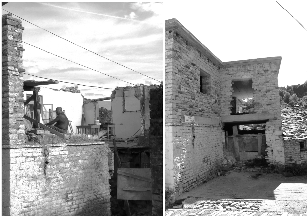
Abb. 66 & 67: Illegaler Denkmalabbruch (Oktober 2011) und historistischer Neubau 68 (Fotos: G. Glötzl, 2011 u. K. Merxhani, 2012)
