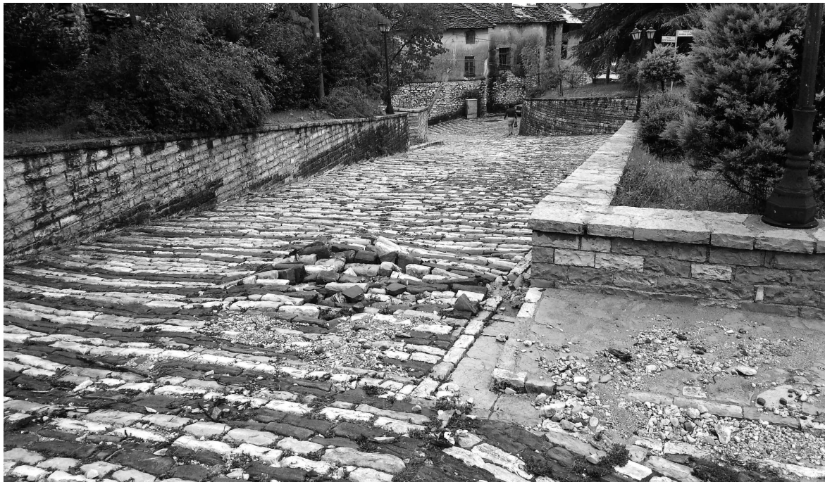
Abb. 56: Desolater Zustand von Pflastersteinstraßen in Gjirokastras Altstadt
