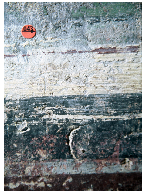
Abb. 229 Befund 043-K37, auch das weiße Band ist pastos aufgetragen und überdeckt, analog zu dem grünen, den Übergangsbereich der Wandzonen.
