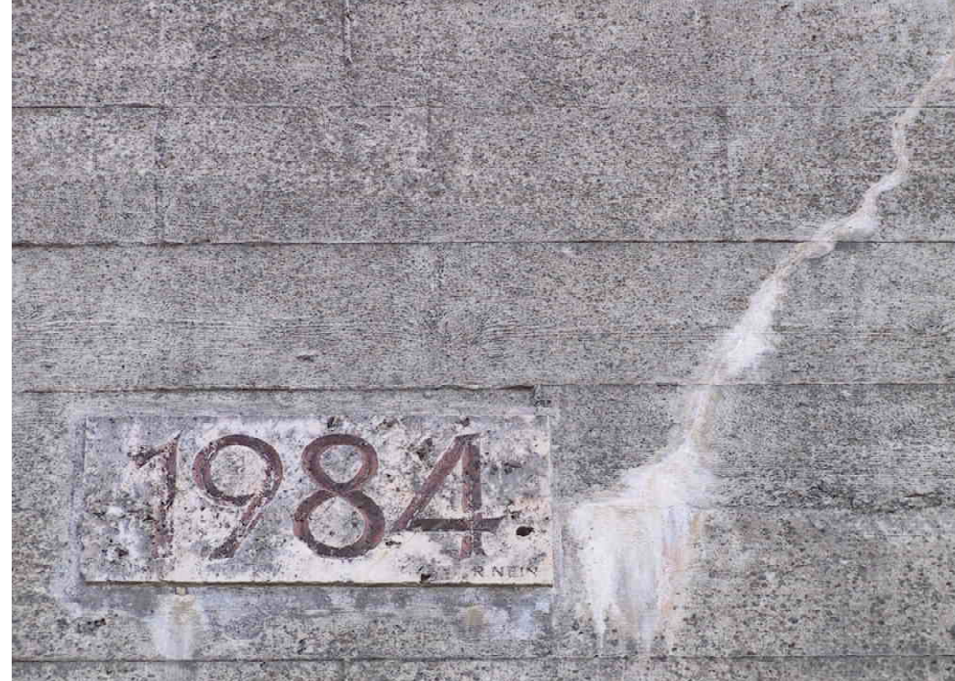
F 338 Kurtine Amalie-Schnaittach Risse und Aussinterungen 2003 S. Thole
