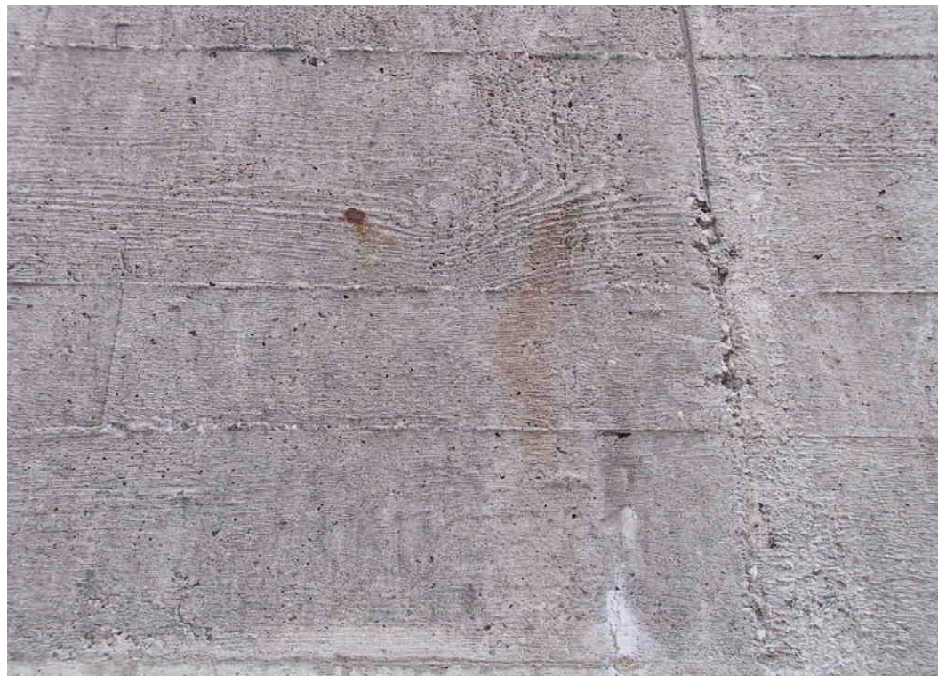
F 347 Betonschäden Korrosionsspuren 2003 S. Thole
