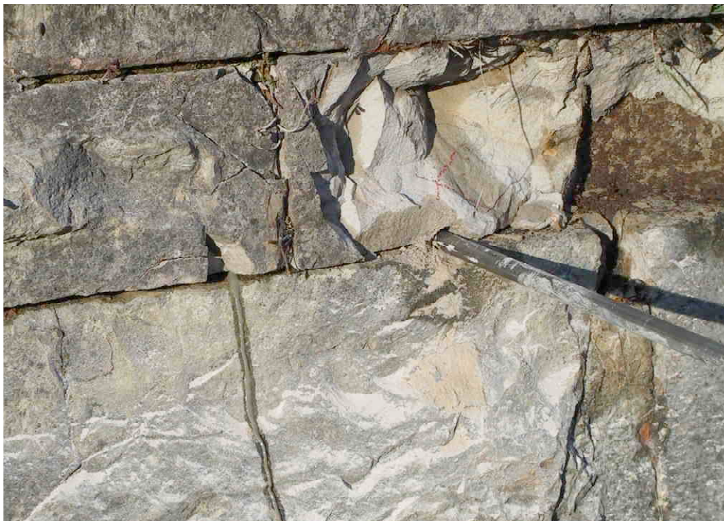
F 375 Verpressung 1 im November 2003 Fugenaustritt 2003 S. Thole
