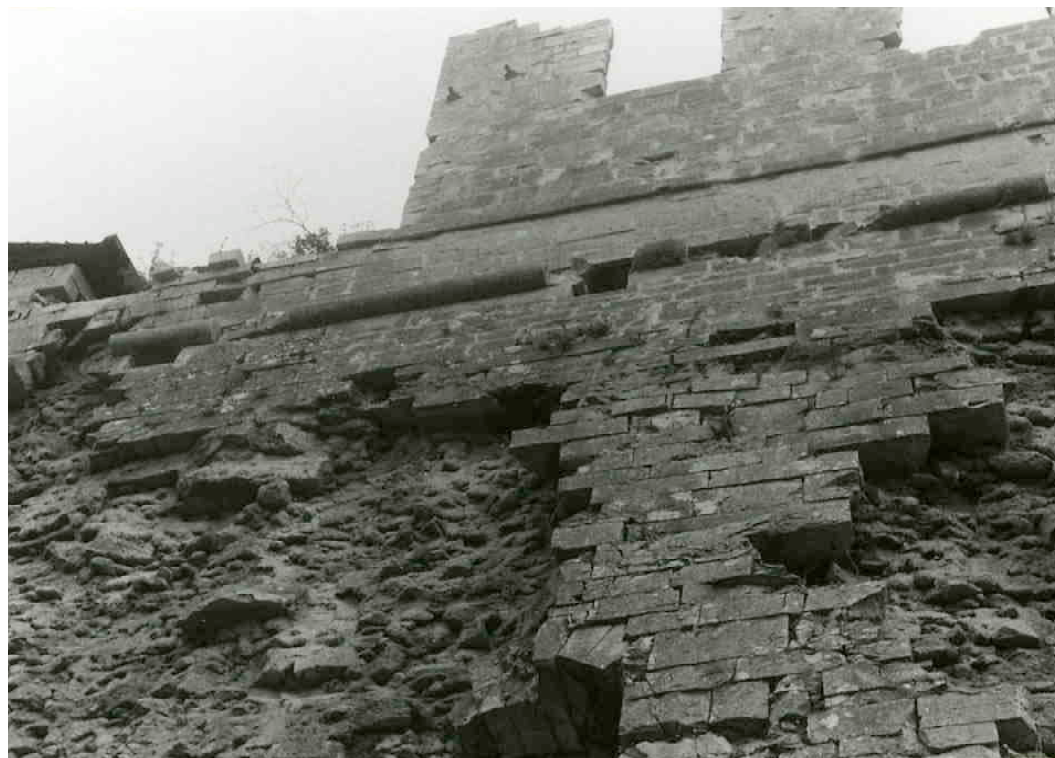
F 235 Kurtine zwischen den Bastionen Amalie und Schnaittach Torkretierungsarbeiten 1984 A. Wörler Heimatverein Schnaittach
