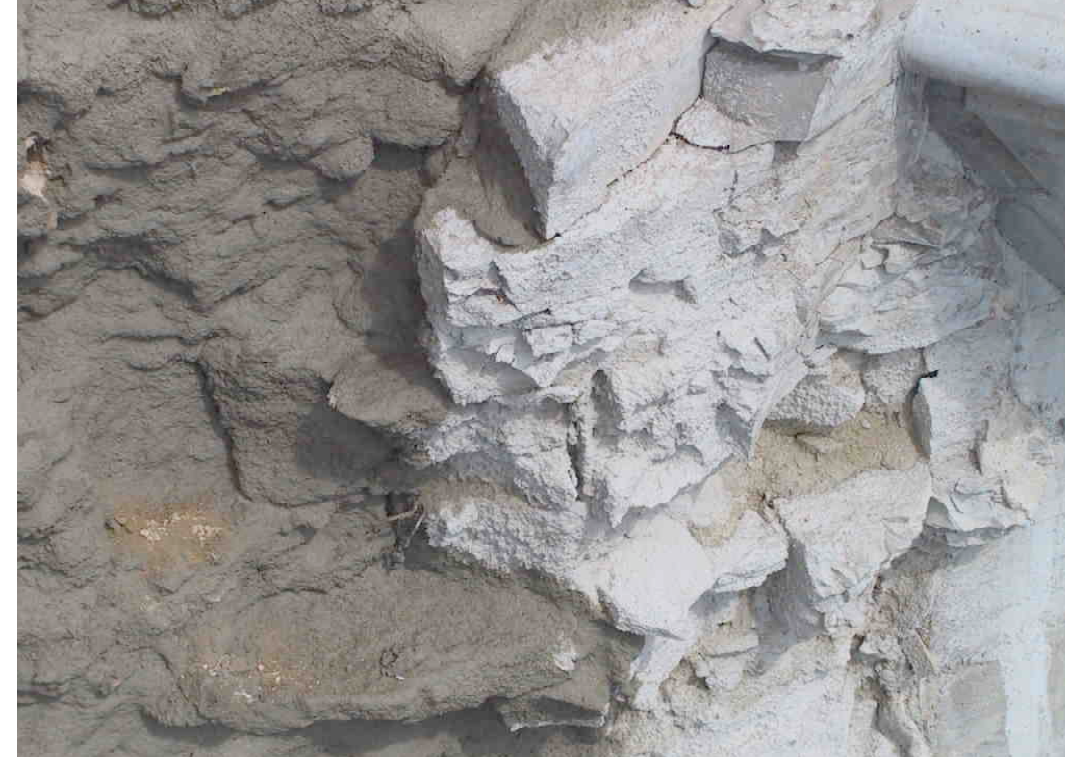
F 326 Bastion Glatzenstein Vorgespritzter Mauertorso 2003 S. Thole
