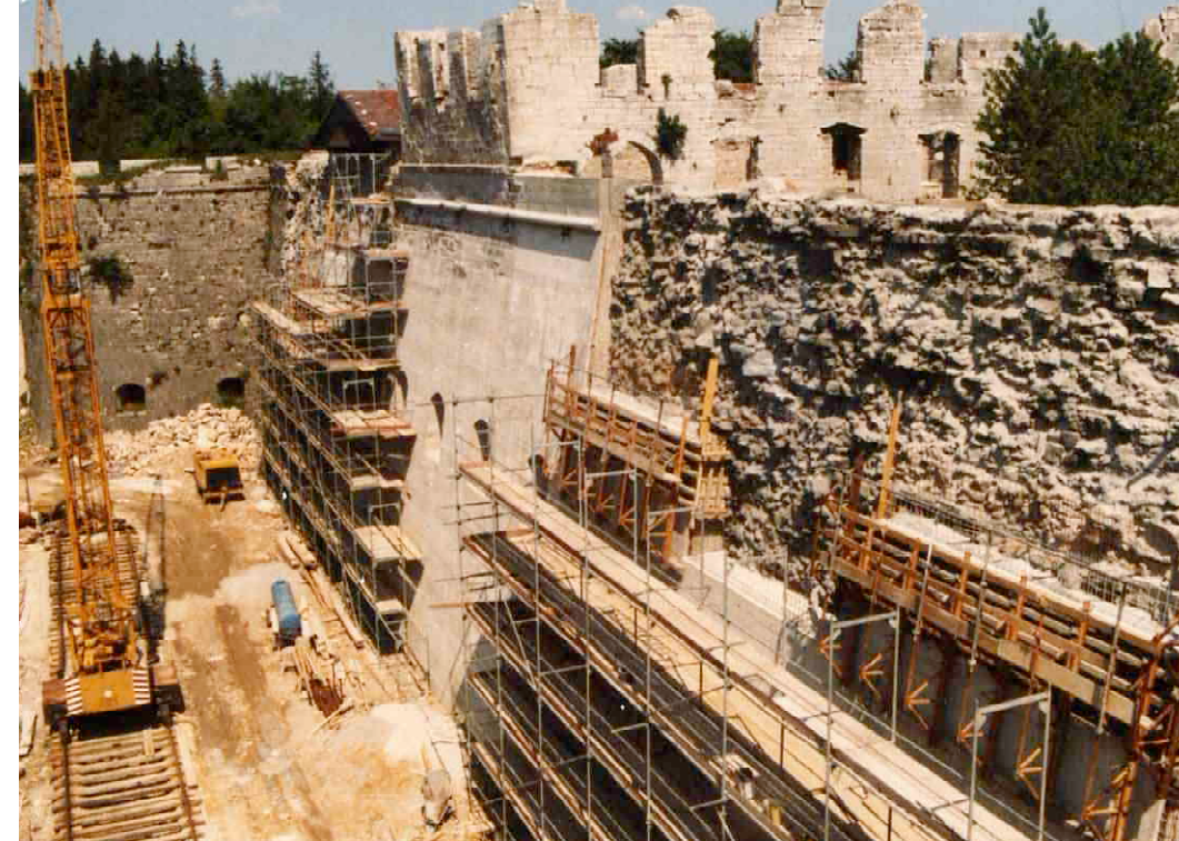
F 246 Kurtine zwischen den Bastionen Amalie und Schnaittach Betonsanierung 1985 Unbekannt Heimatverein Schnaittach
