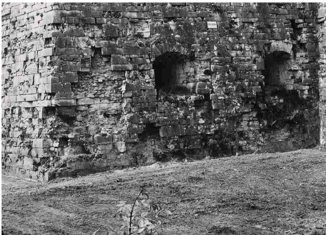
F 167 Bastion Kersbach Mauerschäden an der Ostflanke 1980 W. Kaschel Heimatverein Schnaittach
