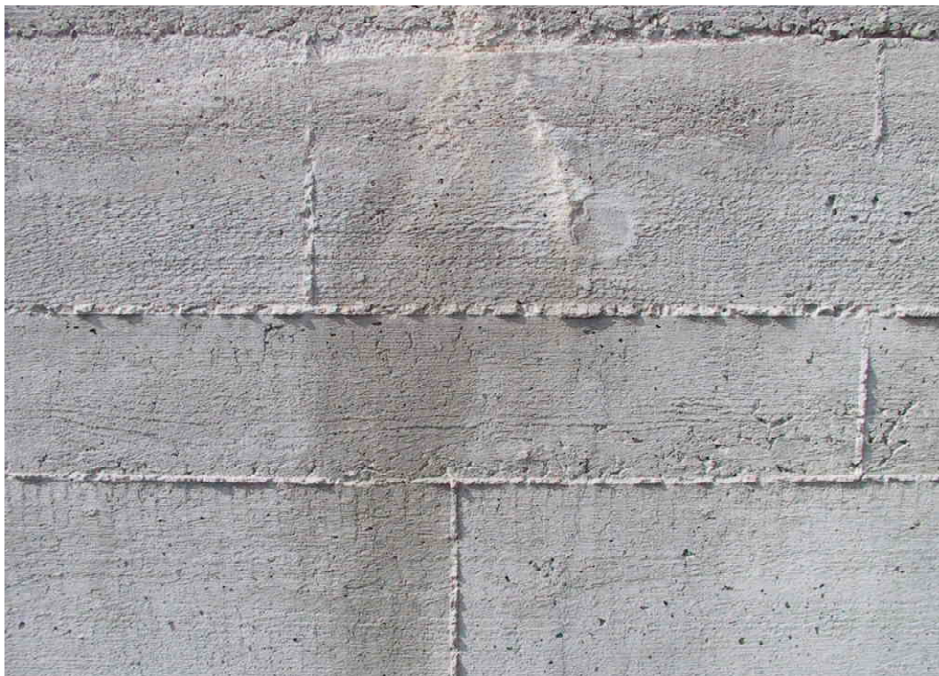
F 339 Betonschäden Risse und Aussinterungen 2003 S. Thole
