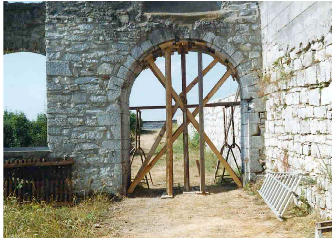
F 299 Zeughaus, Westflügel Instandsetzung der beiden westlichen Tore 1990 W. Kaschel Heimatverein Schnaittach
