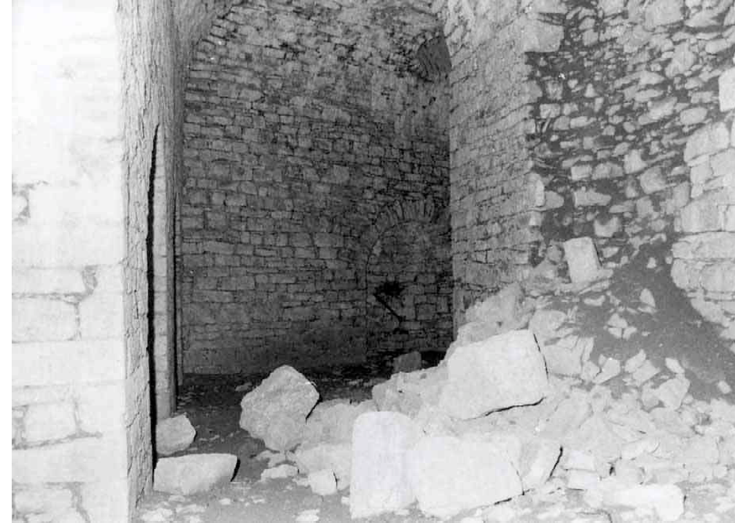
F 190 Bastion Karl Mauereinsturz in der Kasematte 1982 O. Kohlmann Heimatverein Schnaittach
