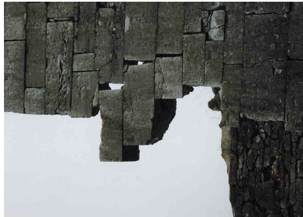
F 306 Amalienkaserne Absturzgefährdete Quader an der Süd-West-Ecke 1990 W. Kaschel Heimatverein Schnaittach
