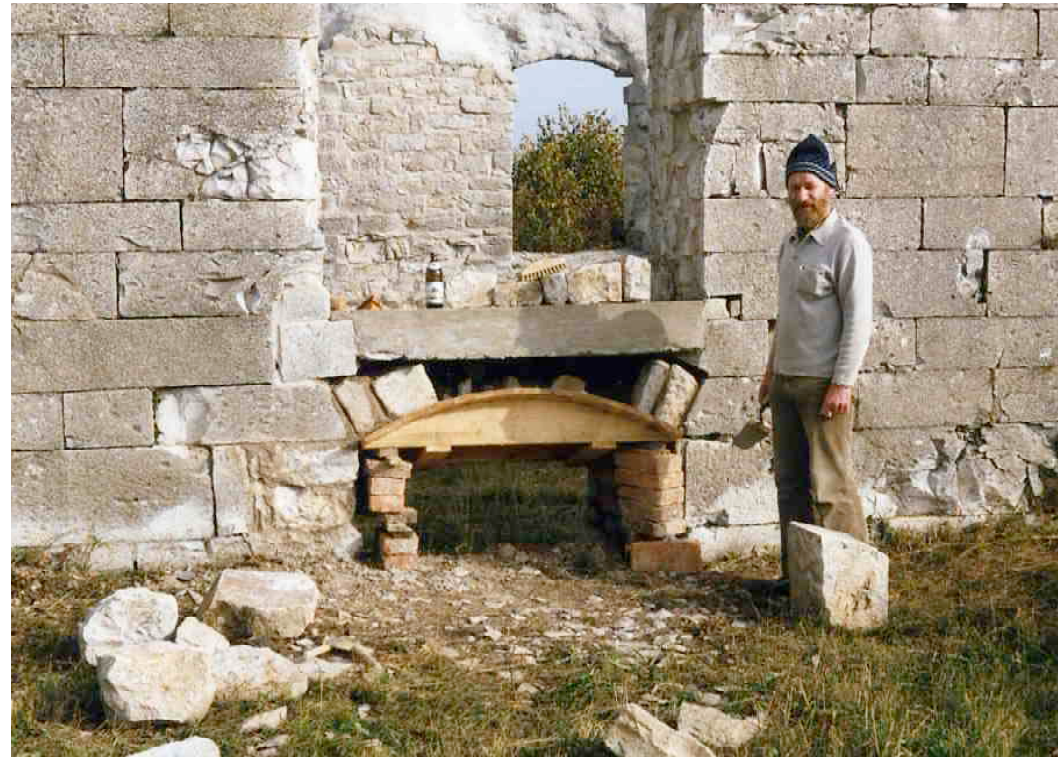
F 283 Zeughaus, Ostflügel Aufmauerung der Bögen über den Luftschachtöffnungen 1987 W. Kaschel Heimatverein Schnaittach
