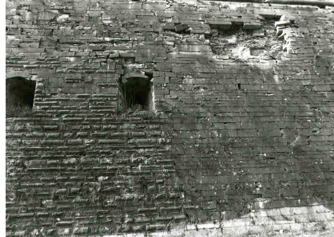
F 270 Kurtine zwischen den Bastionen Glatzenstein und Kersbach Ausbruchstelle an der Ostflanke
