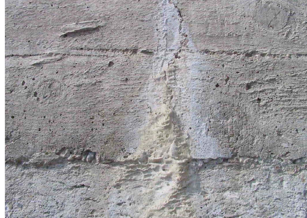
F 342 Betonschäden Risse und Aussinterungen 2003 S. Thole
