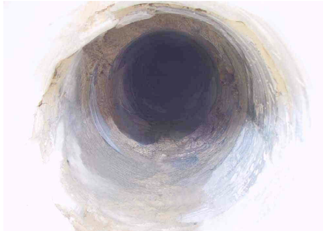
F 429 Blick in Bohrkernloch A 3 Kurtine zwischen den Bastionen Glatzenstein und Kersbach 2003 S. Thole
