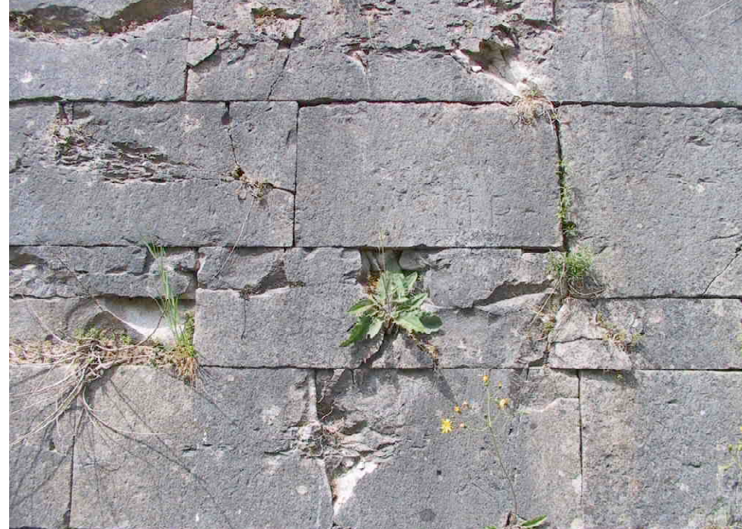
F 314 Grünbewuchs an den Mauern
