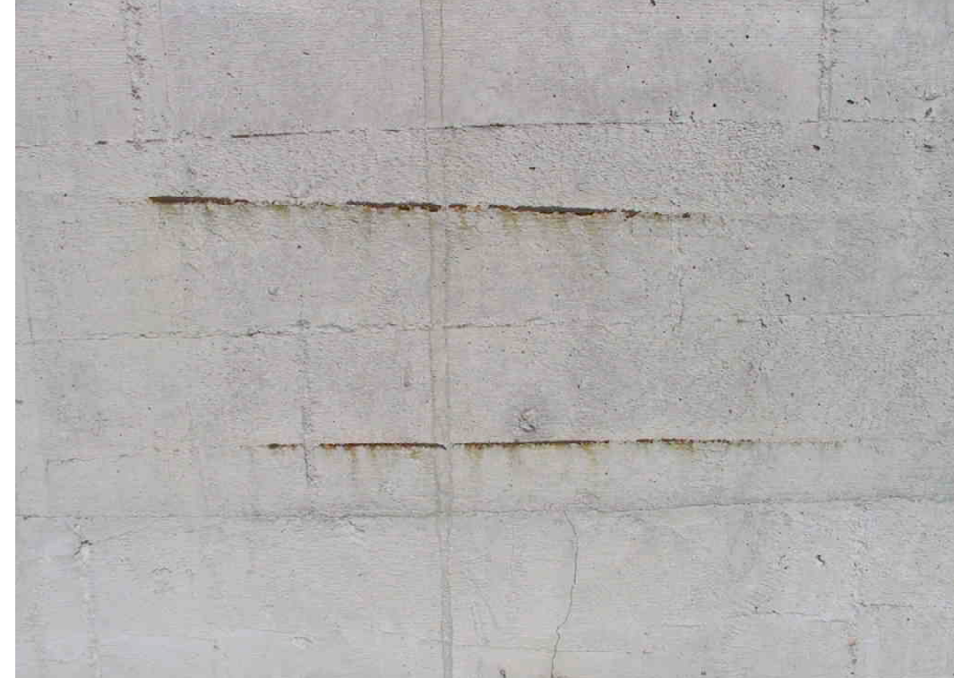
F 346 Korrosionsspuren an Armierung durch mangelnde Beton- abdeckung 2003 S. Thole
