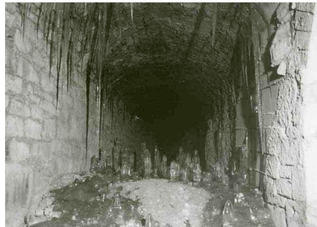
F 180 Kasematten Wassereinbruch
