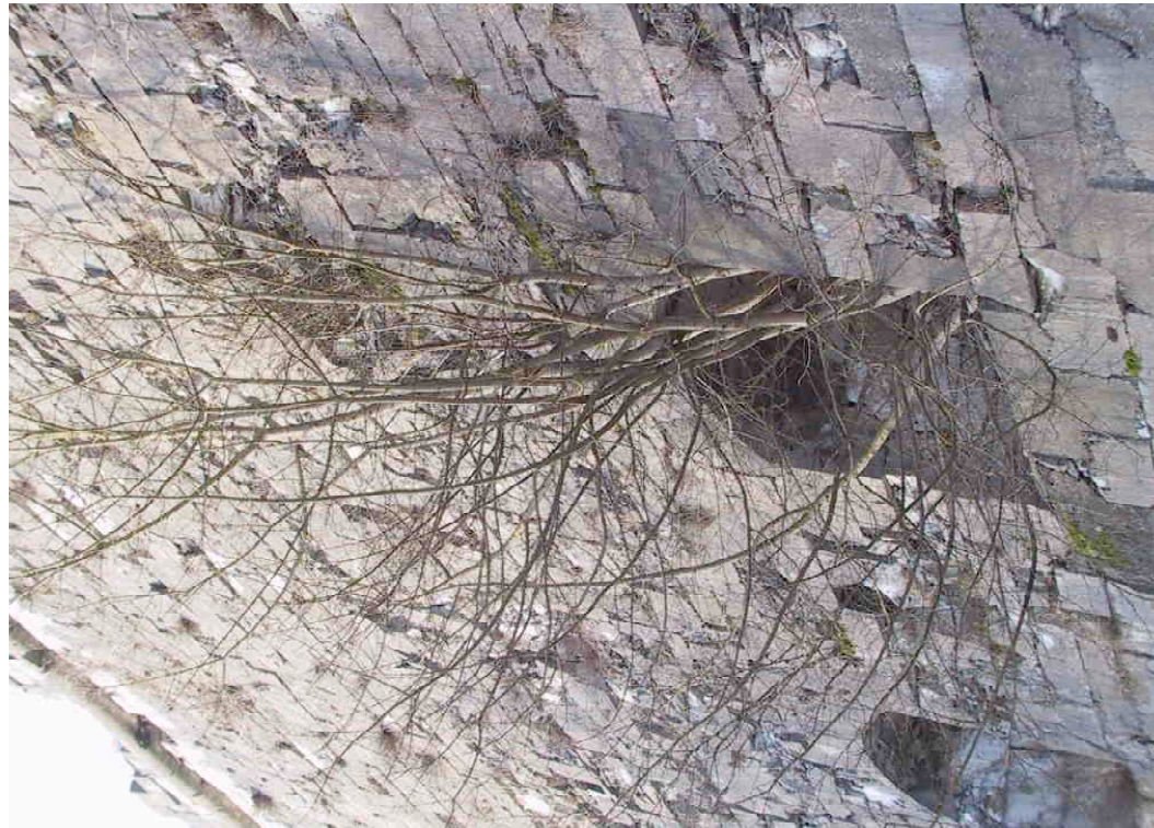
F 313 Grünbewuchs an den Mauern
