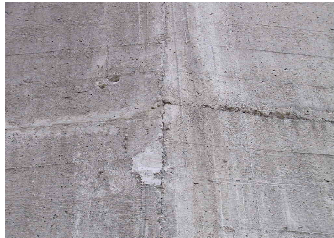
F 348 Betonschäden Risse an Betonierfugen 2003 S. Thole
