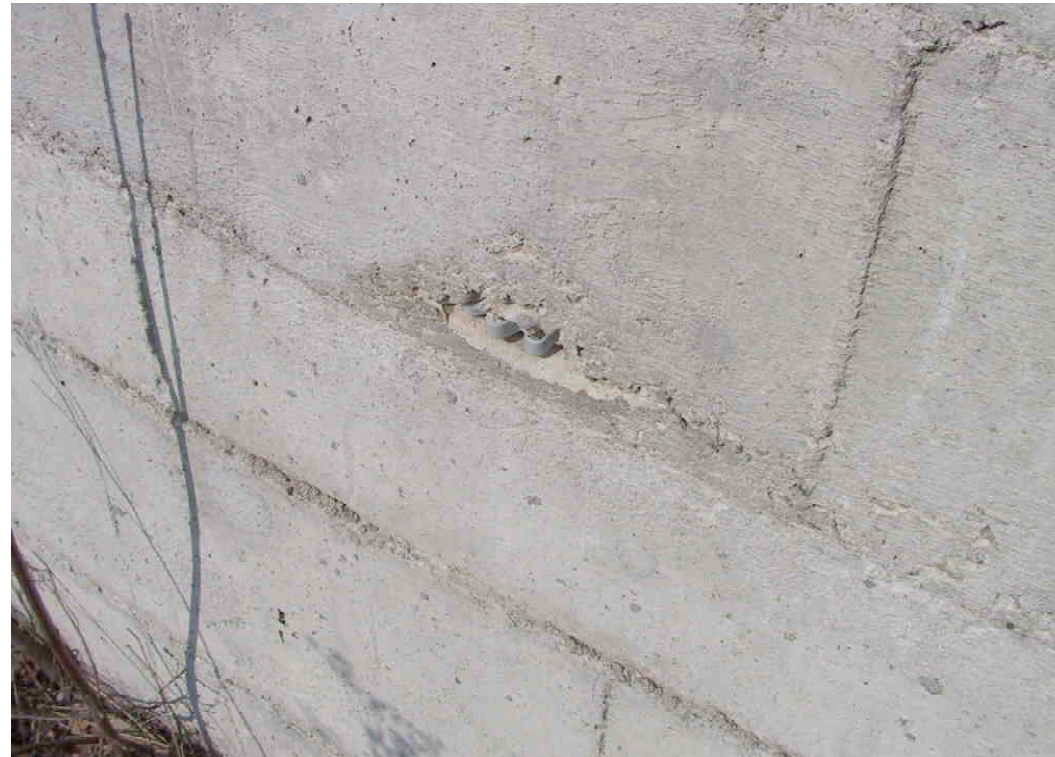
F 345 Betonschäden Betonausbruch an Abstandshalter 2003 S. Thole
