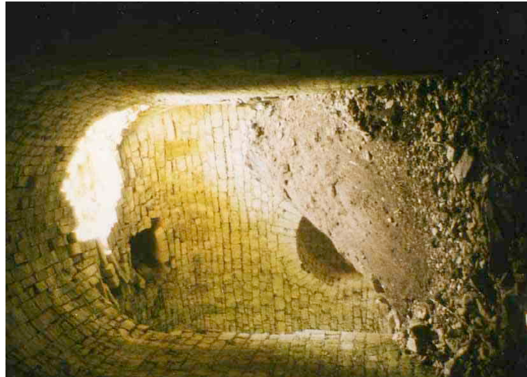
F 221 Großer Kasemattensaal Gewölbeeinbruch
