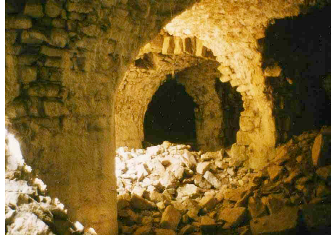
F 222 Großer Kasemattensaal Gewölbeeinbruch
