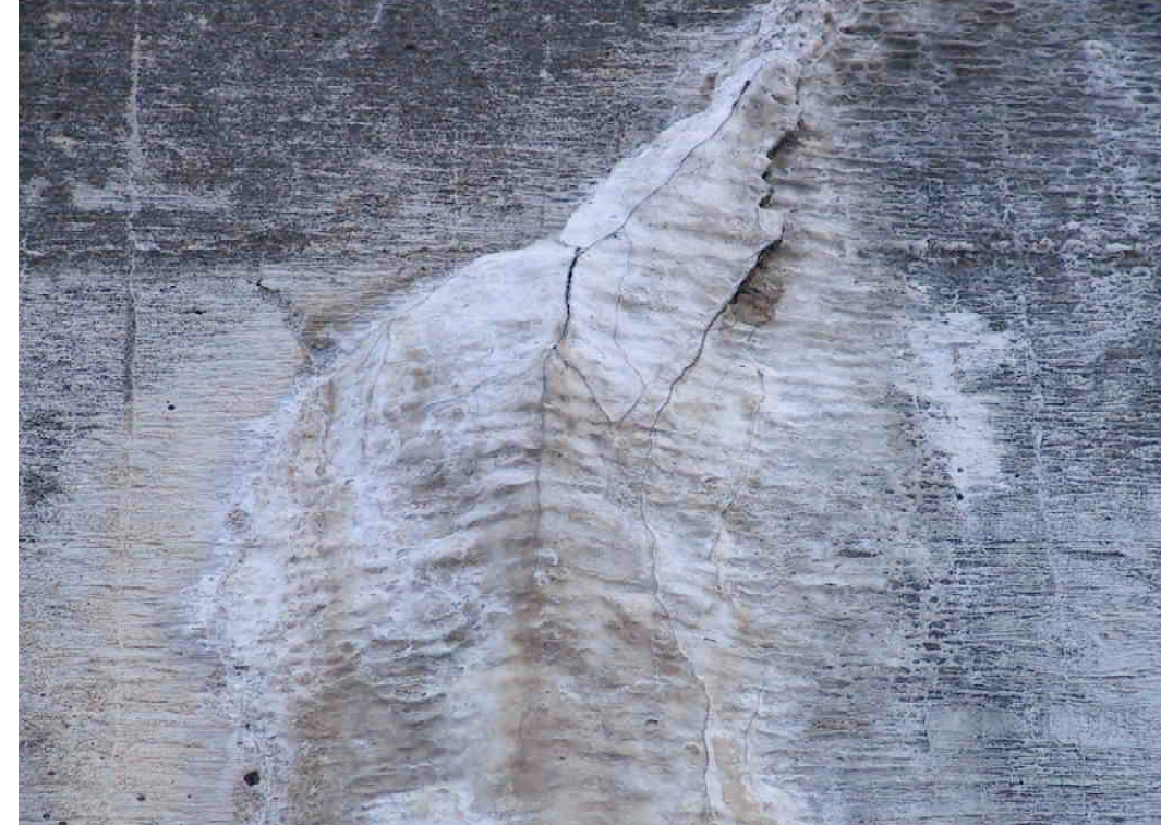
F 350 Betonschäden Risse, Aussinterungen und Betonabplatzungen 2003 S. Thole
