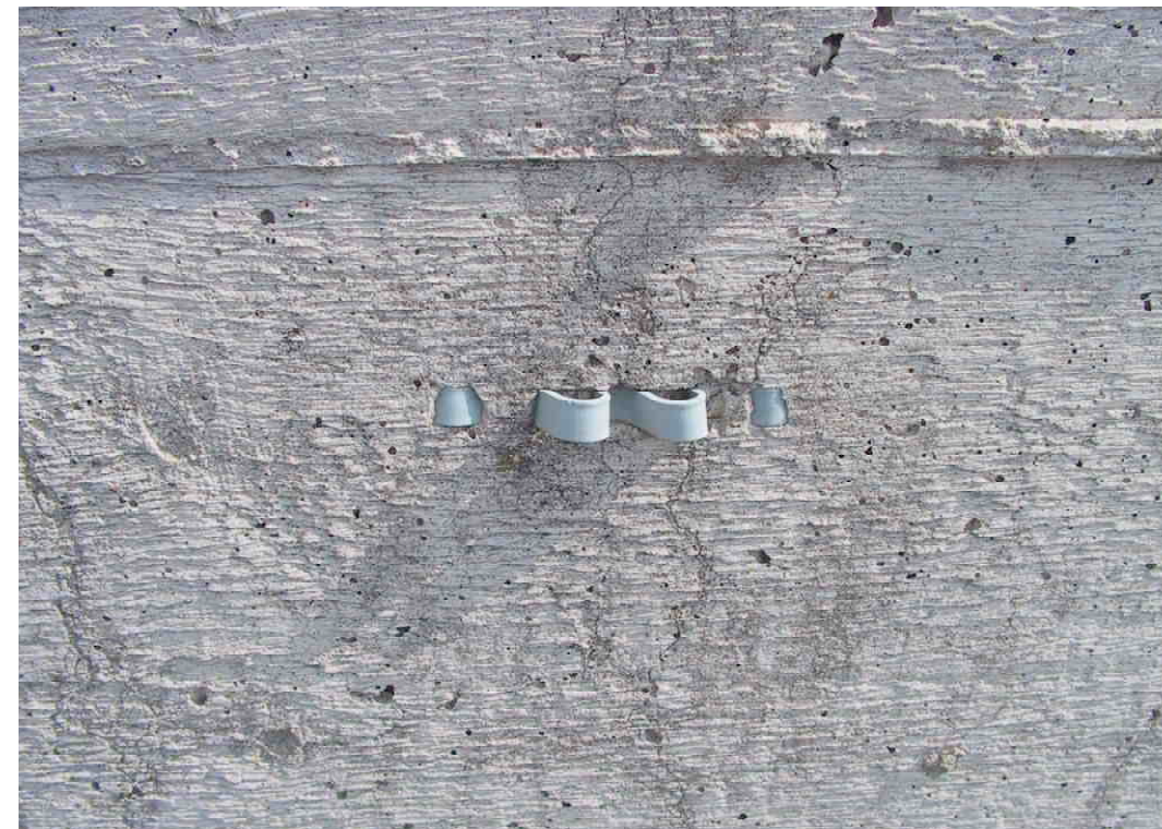
F 344 Betonschäden Risse und mangelnde Betonüberdeckung an Abstandshalter 2003 S. Thole
