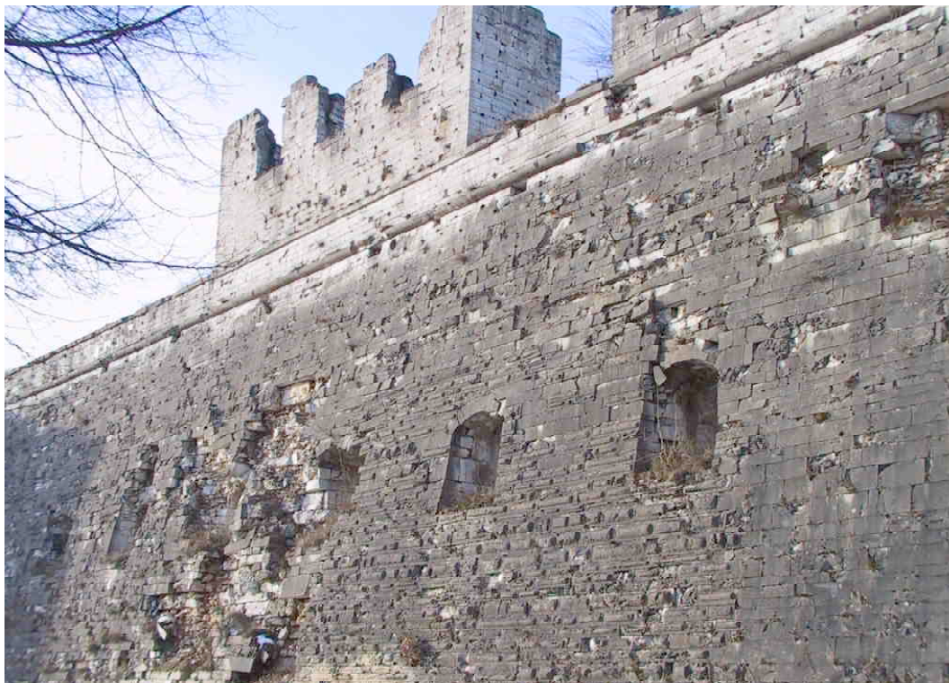
F 379 Kurtine zwischen den Bastionen Glatzenstein und Kersbach Mauerschäden 2003 S. Thole
