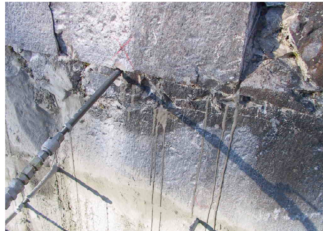
F 376 Verpressung 1 im November 2003 Fugenaustritt 2003 S. Thole
