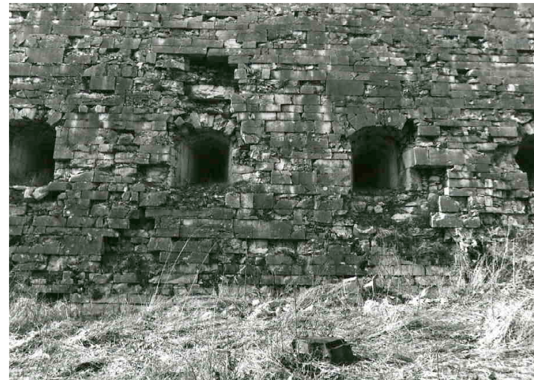
F 272 Bastion Kersbach Mauerschäden an der Ostflanke
