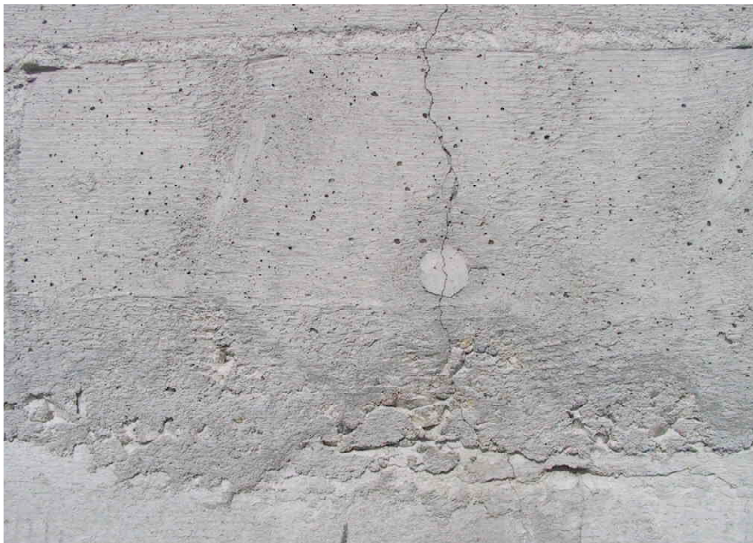
F 343 Betonschäden Risse 2003 S. Thole
