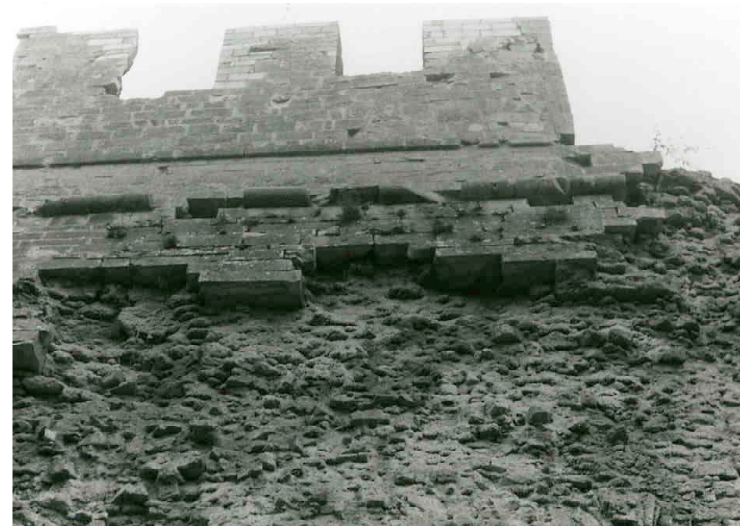
F 236 Kurtine zwischen den Bastionen Amalie und Schnaittach Torkretierungsarbeiten 1984 A. Wörler Heimatverein Schnaittach
