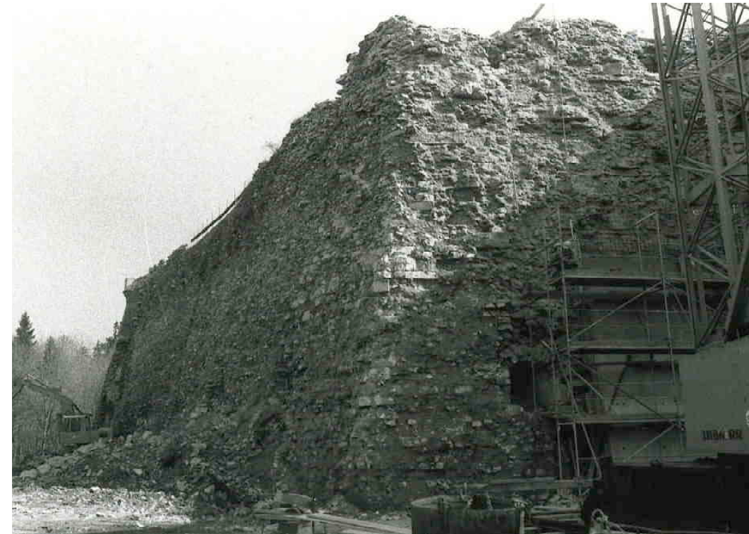
F 250 Bastion Amalie Zustand vor der Sanierung
