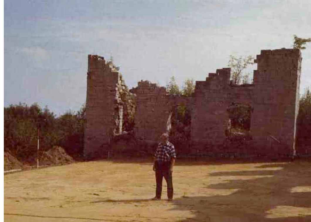
F 130 Pfarr- und Schulhaus Planierter Erdboden zum Auflegen der Isolierfolie 1970 Unbekannt Heimatverein Schnaittach
