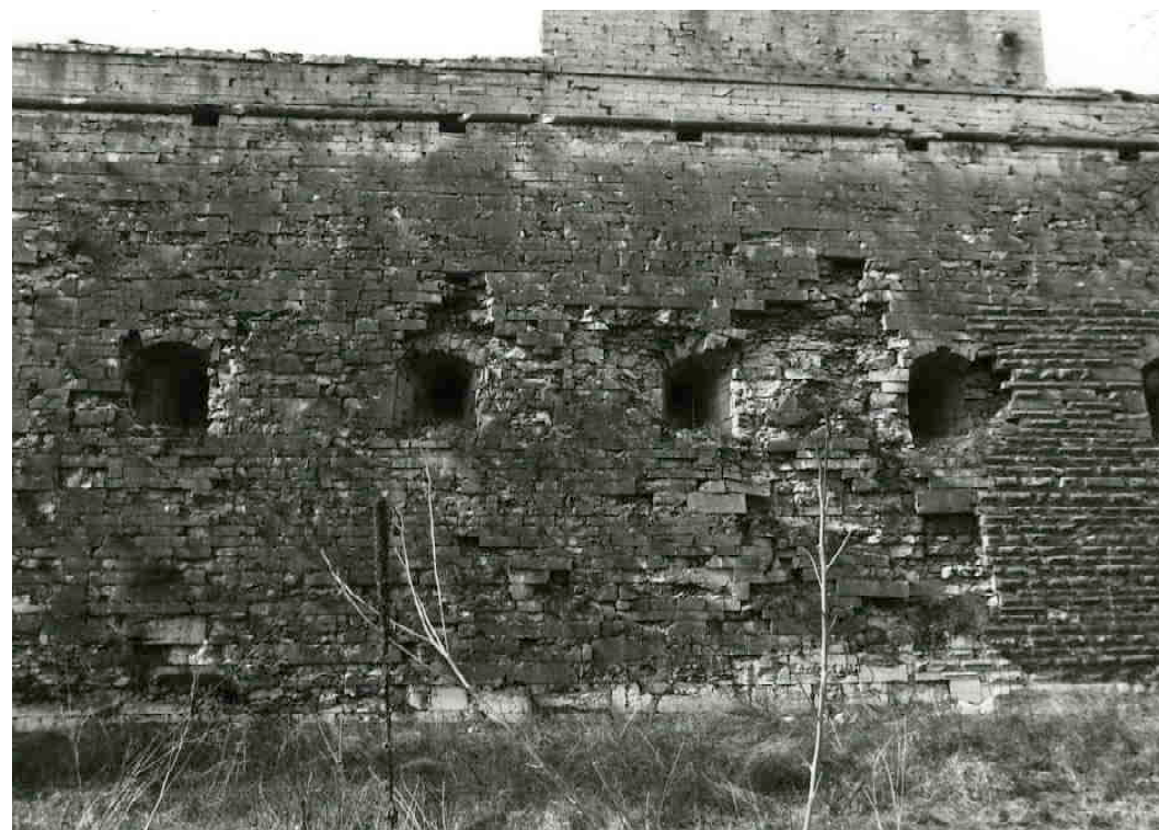
F 271 Kurtine zwischen den Bastionen Glatzenstein und Kersbach Mauerschäden
