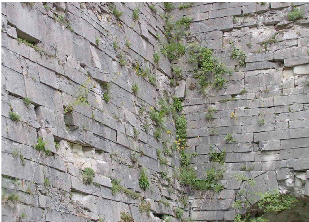
F 315 Grünbewuchs an den Mauern
