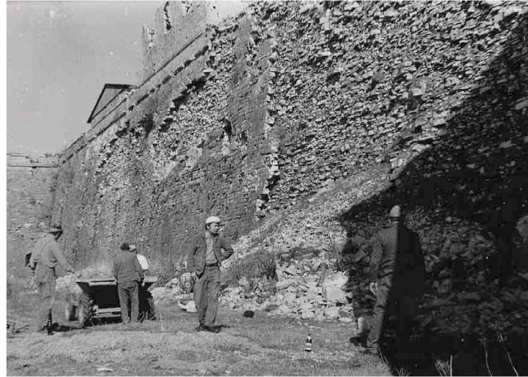
F 154 Kurtine zwischen den Bastionen Amalie und Schnaittach Mauerschäden 1974 W. Kaschel Heimatverein Schnaittach
