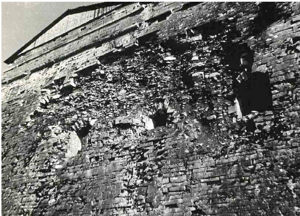
F 155 Kurtine zwischen den Bastionen Amalie und Schnaittach Mauerschäden unterhalb der Kommandantur 1974 W. Kaschel Heimatverein Schnaittach
