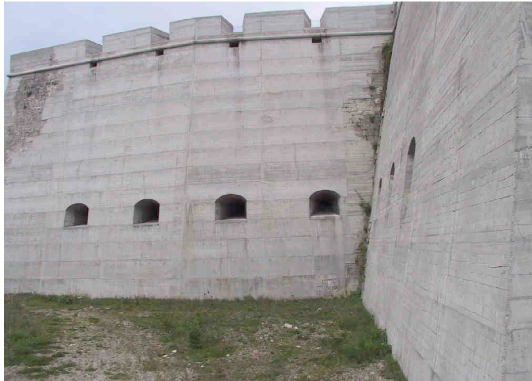
F 337 Bastion Nürnberg Betonschäden 2003 S. Thole
