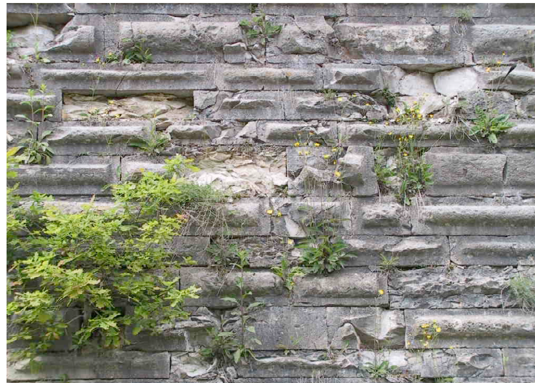
F 316 Grünbewuchs an den Mauern
