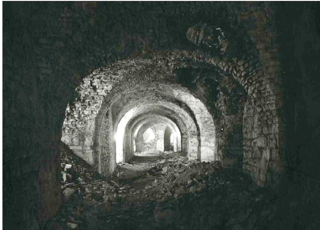
F 049 Kasematte Einbruch der Gewölbe
