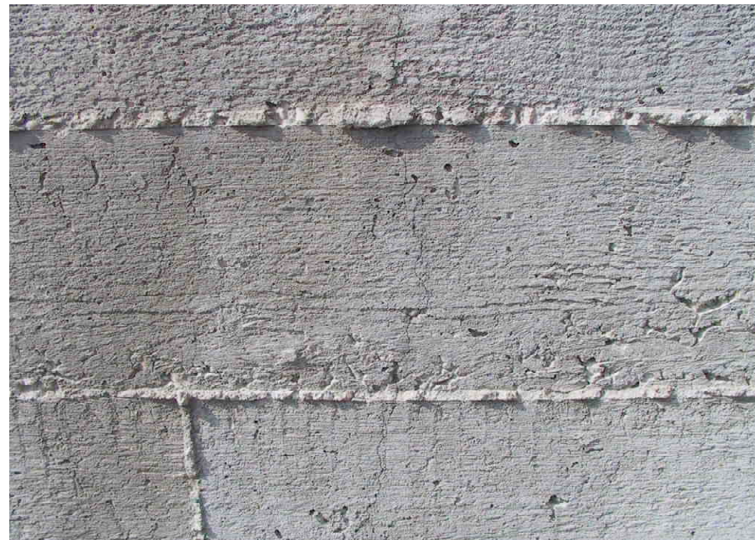
F 340 Betonschäden Risse 2003 S. Thole
