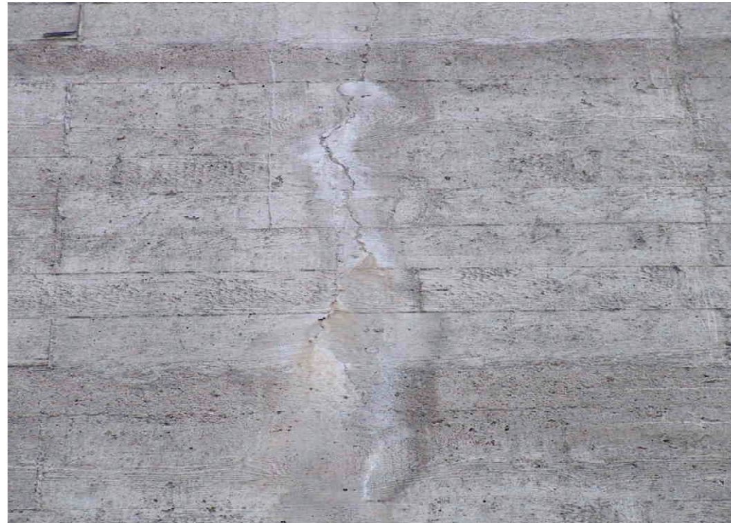
F 349 Betonschäden Risse und Aussinterungen 2003 S. Thole
