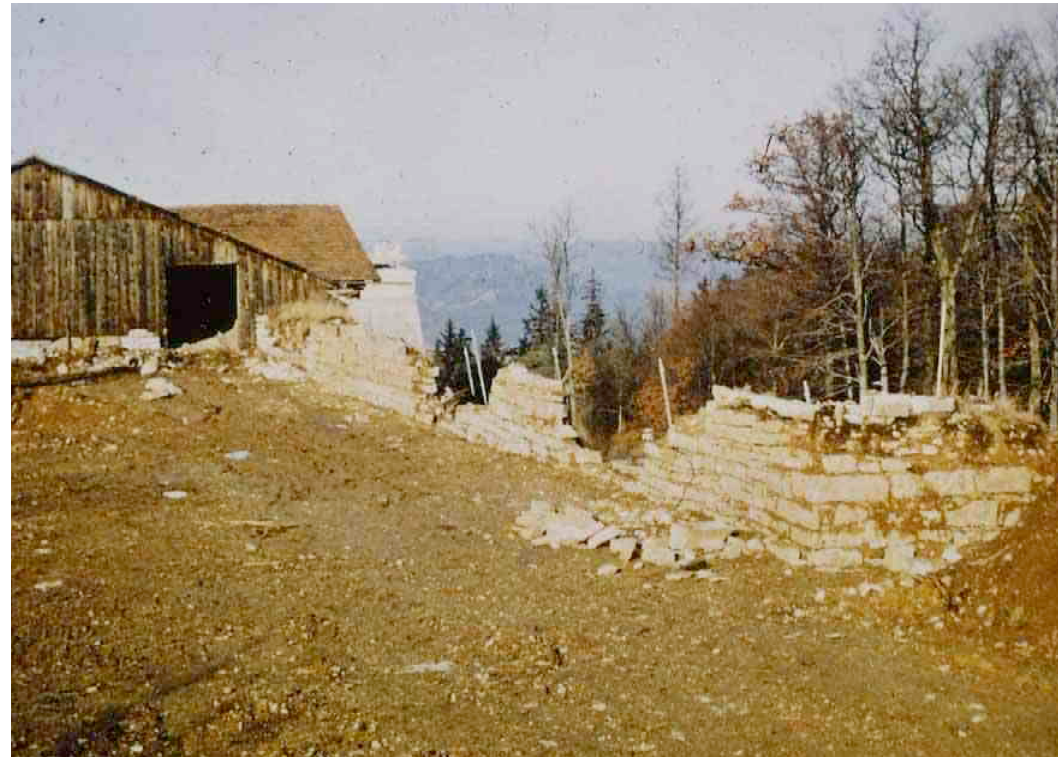
F 141 Kurtine zwischen Bastion Karl und Portal Eingestürzte und verwitterte Brüstung 1974 W. Kaschel Heimatverein Schnaittach
