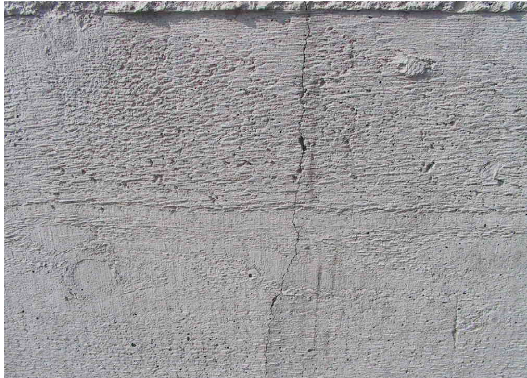
F 341 Betonschäden Risse 2003 S. Thole
