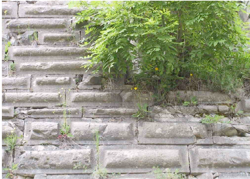
F 317 Grünbewuchs an den Mauern 2003 S. Thole
