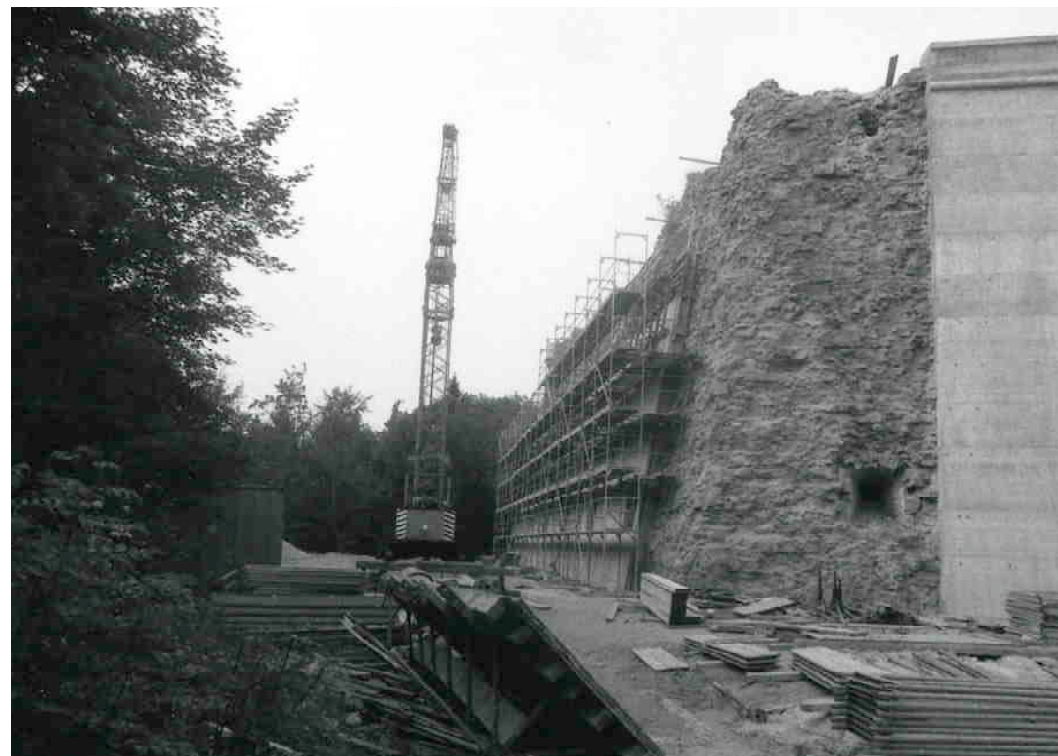
F 263 Bastion Amalie Torkretierung der Mauer vor der Betonverschalung 1986 A. Wörler Heimatverein Schnaittach
