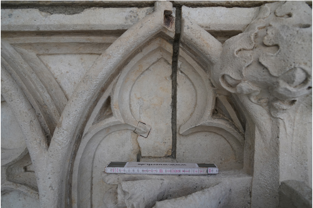
Abb. 2 Passau, St. Stephan, Portal zum ehemaligen Kreuzgang, Anfang 15. Jh., bauzeitliche Vierung und fehlende Vierung im Blendmaßwerk links der Kreuzblume
