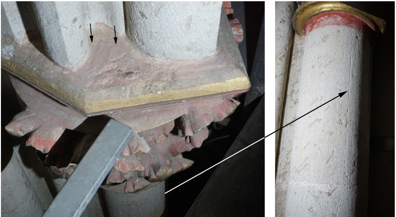
Abb. 11 Köln, Dom, Chorkapelle (Engelbertuskapelle), Gewölbekapitell mit angerissenem Umriss des alten Dienstes (links, Pfeile), Ritzlinie auf altem Dienst unter dem Kapitell (rechts)
