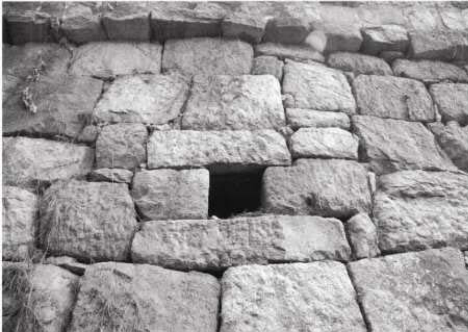
Abb. 16-9 Außenansicht einer Schießscharten in der unteren Feuerebene des Wallabschnittes am Pavillon der Generäle im Westen, Hwaseong Jangdae , 2005
