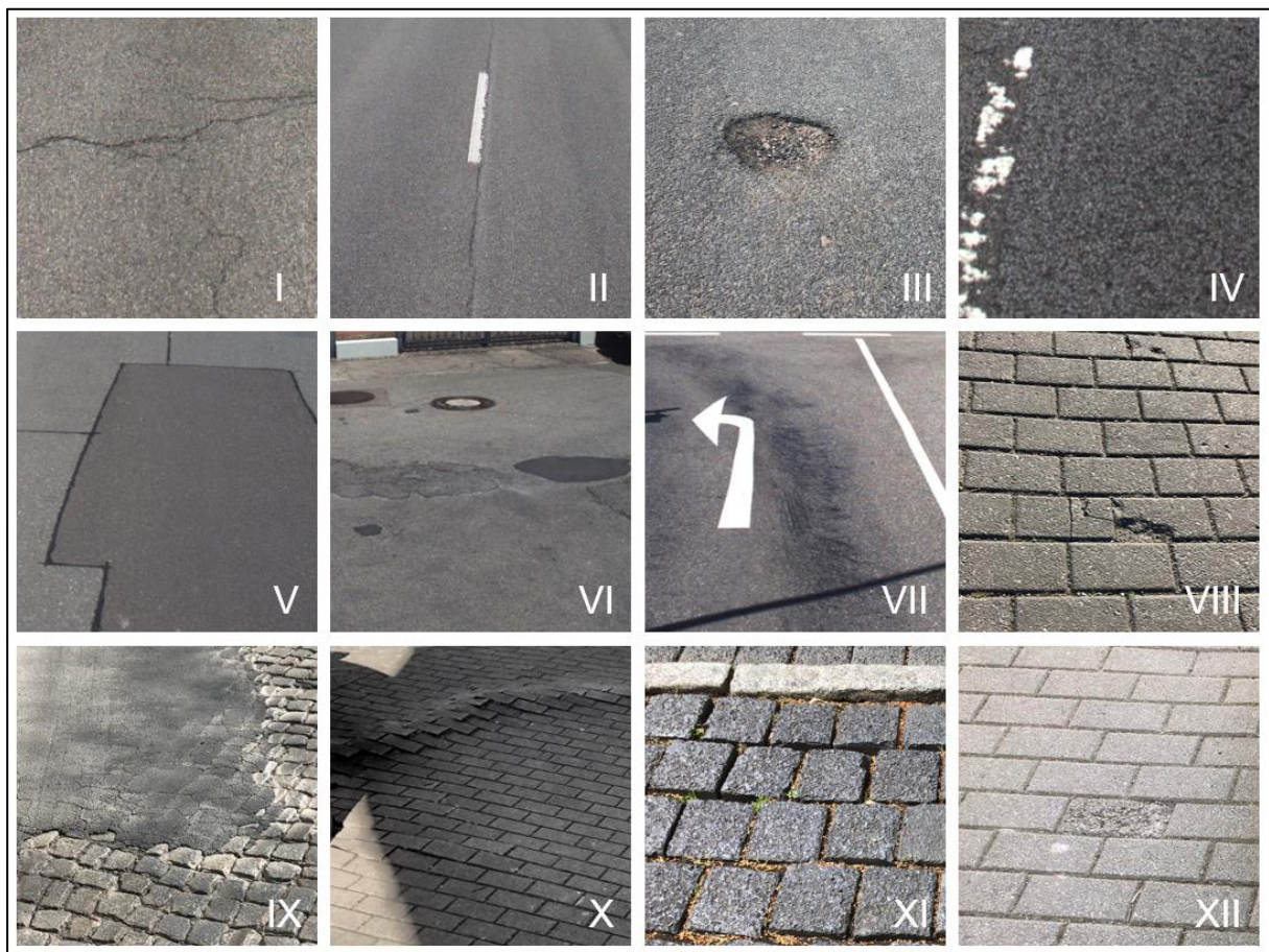
Abbildung 14: Beispiele für die auf kommunalen Straßen relevanten Schadensarten Riss (I), offene Naht (II), Ausbruch (III), Ausmagerung (IV), eingelegte Flickstelle (V), aufgelegte Flickstelle (VI), Bindemittelanreicherung (VII), schadhaftes Pflasterelement (VIII), Flickstellen (IX), Lagerungsschaden (X), offene Pflasterfuge (XI) und Gefügelösungen (XII).
