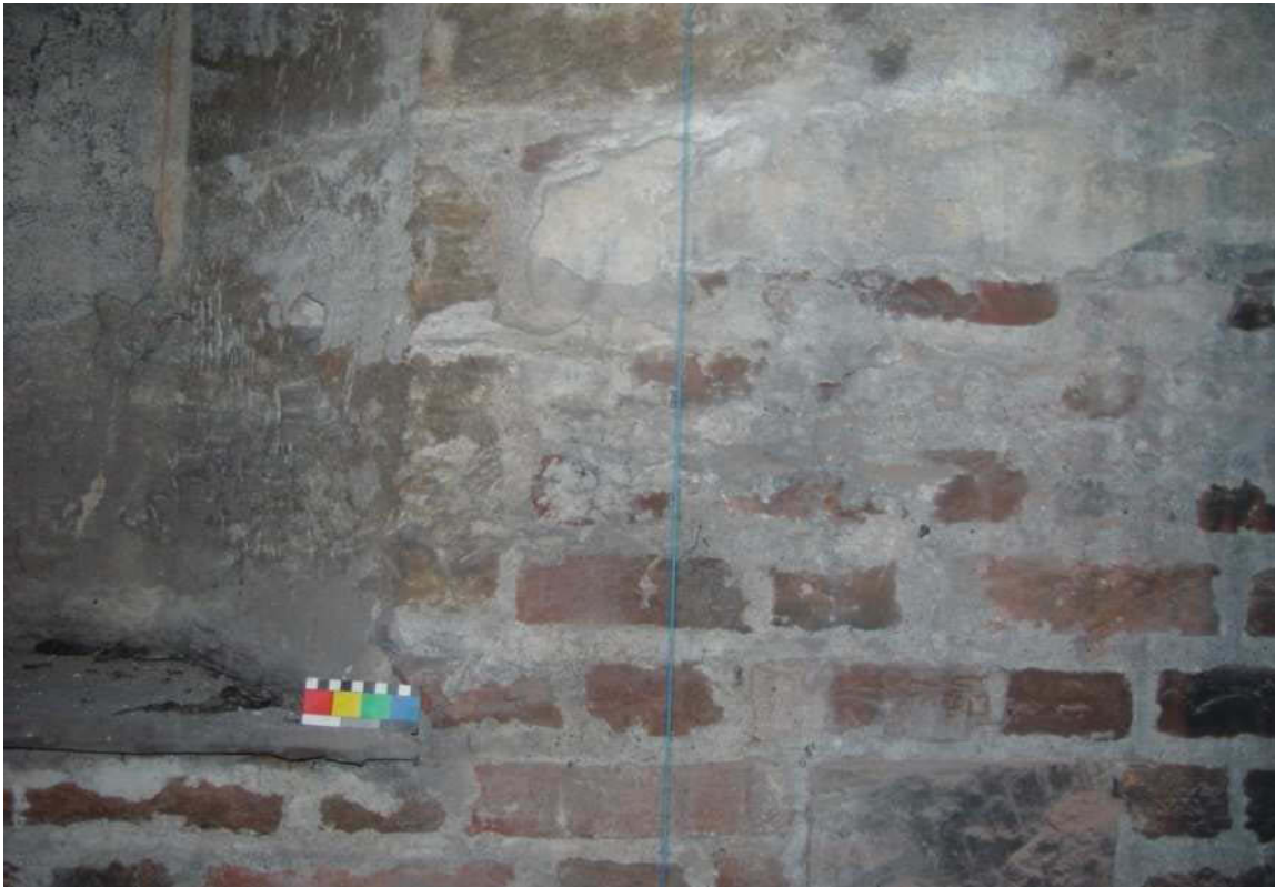
Abb.17.522: Putzreste auf Ziegelmauerwerk an der Ostfassade des Langhauses.
